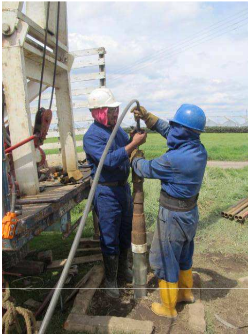
Instalaciones para la Inyección de Aire Comprimido
